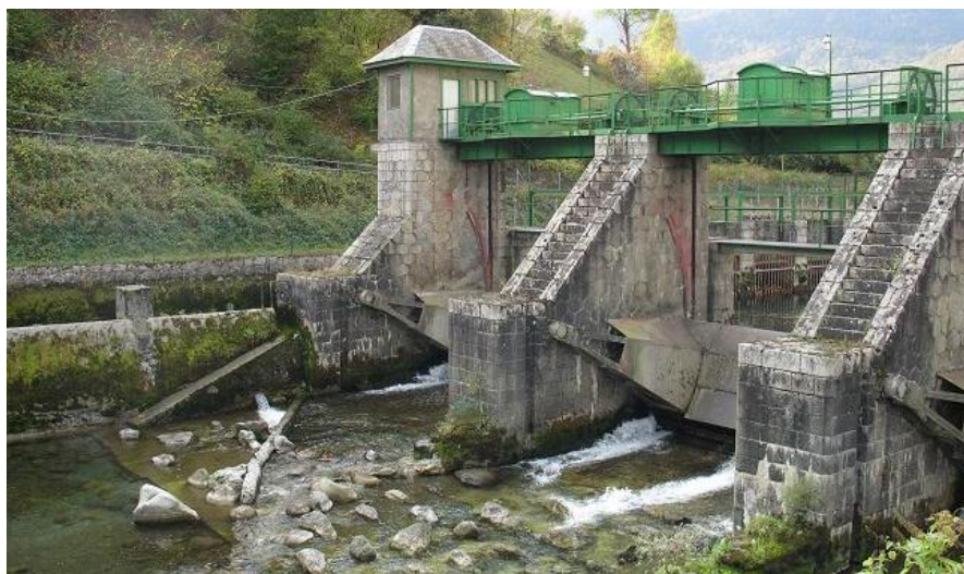
Figura 56-11. Azud de derivación aguas abajo de la localidad de Bossost.
