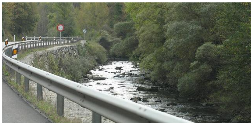
Figura 56-8. Defensa de margen asociada a la protección frente a erosión de la carretera N-230.
