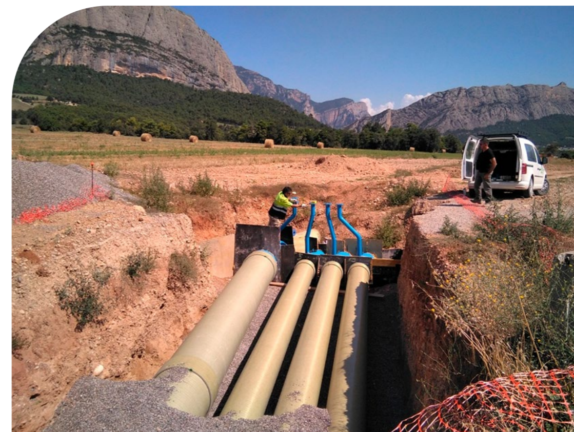
Tuberías de distribución
