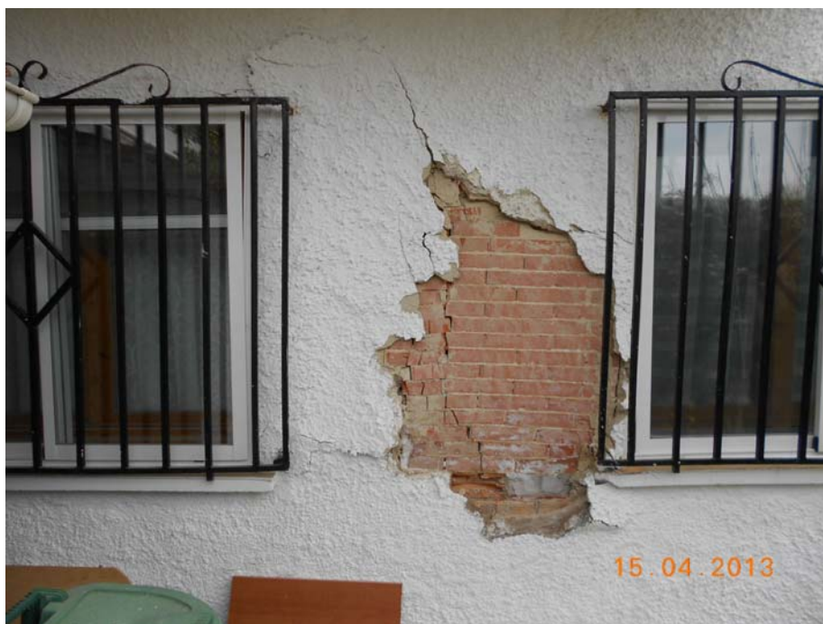
Figura 4.1.24: Detalle de los daños provocados por la grieta intermedia en la fachada del patio de la vivienda situada entre las calles 3 y 4. Se observa como la fachada de la casa está constituida por ladrillos huecos con enfoscado de cemento.
