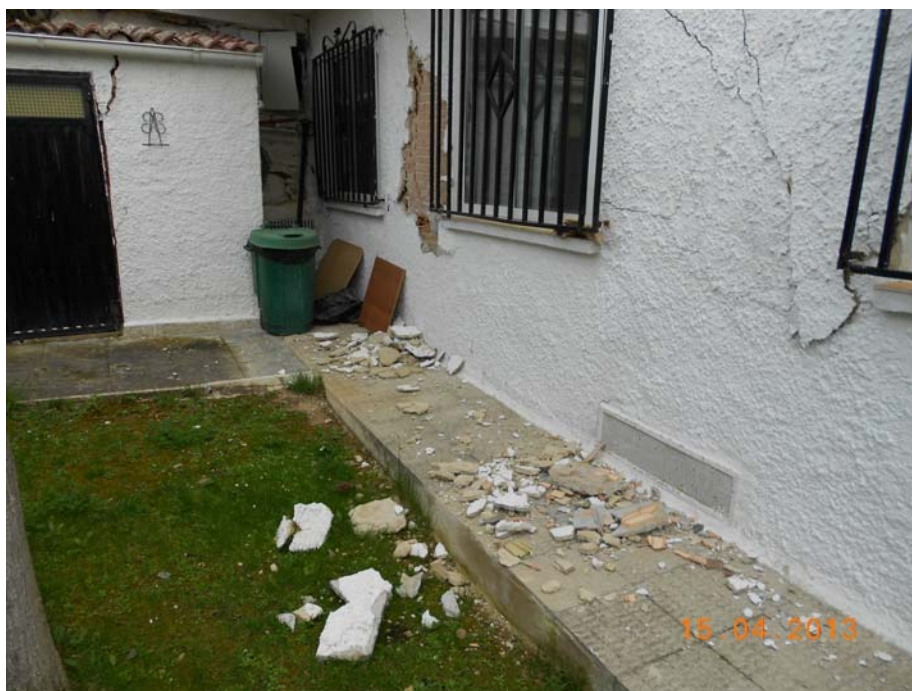
Figura 4.1.23: Vista de los daños provocados por la grieta intermedia en la fachada del patio de la vivienda situada entre las calles 3 y 4.
