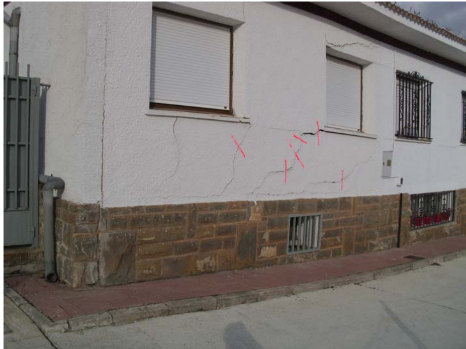
Figura 4.1.17: Vista de la fachada exterior de la vivienda nº 20, situada en la calle 3 de la urbanización Lasaitasuna, coincidiendo con el límite Oeste de la masa inestable. Esta vivienda ha sido claramente afectada por el movimiento diferencial que se ha producido en el terreno al situarse en el límite del deslizamiento. Las viviendas que se encuentran dentro o fuera de la masa inestable no presentan daños de consideración similar.
