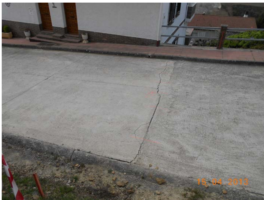
Figura 4.1.22: Vista de la grieta transversal observada en le calle 4 de la Urbanización Lasaitasuna, que corresponde a la grieta intermedia situada a una distancia creciente de 50 a 100 m respecto a la que constituye el límite Oeste. Provoca daños en viales, muros y viviendas.
