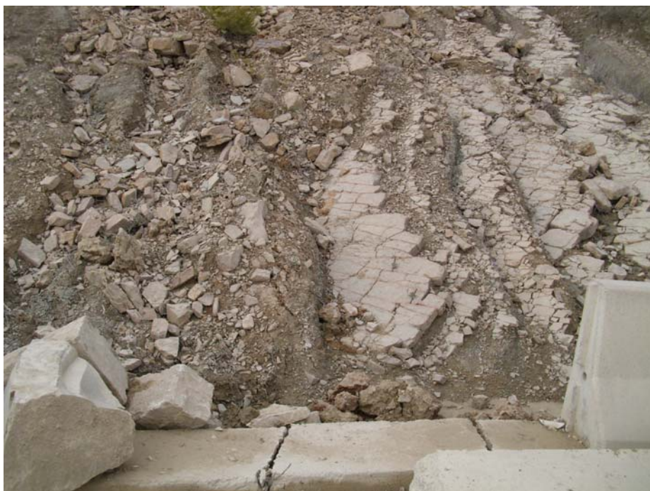
Figura 4.1.6: Límite Este de la masa desplazada que provoca una rotura en un bordillo de la carretera N-240. El límite de la rotura se sitúa en el flysch muy próximo al contacto con las Margas de Pamplona, en el talud de la propia carretera.
