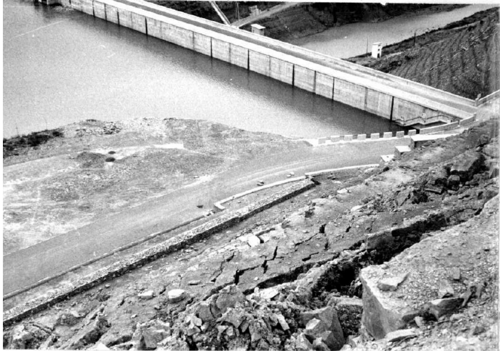
Figura 2.1: Fotografía de la degradación que presentaba el abancalamiento del talud de la ladera derecha en 1964. Servicio Geológico de Obras Públicas.
