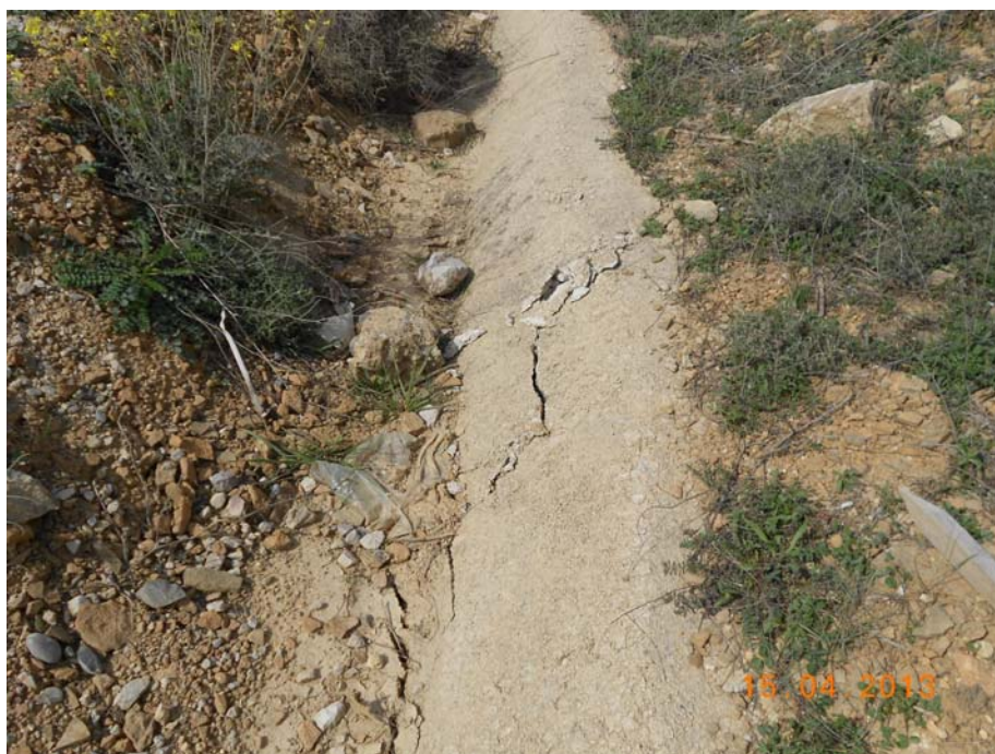
Figura 4.1.25: La grieta intermedia recorre toda la Urbanización Lasaitasuna, de N a S, provocando grietas transversales en viales y en construcciones anexas a las viviendas. No se observa en la CN-240, salvo por una apertura lateral en una junta del aglomerado (figura 4.1.8), volviendo a observarse en un camino que discurre aguas abajo de la CN-240, en una cuneta de hormigón
