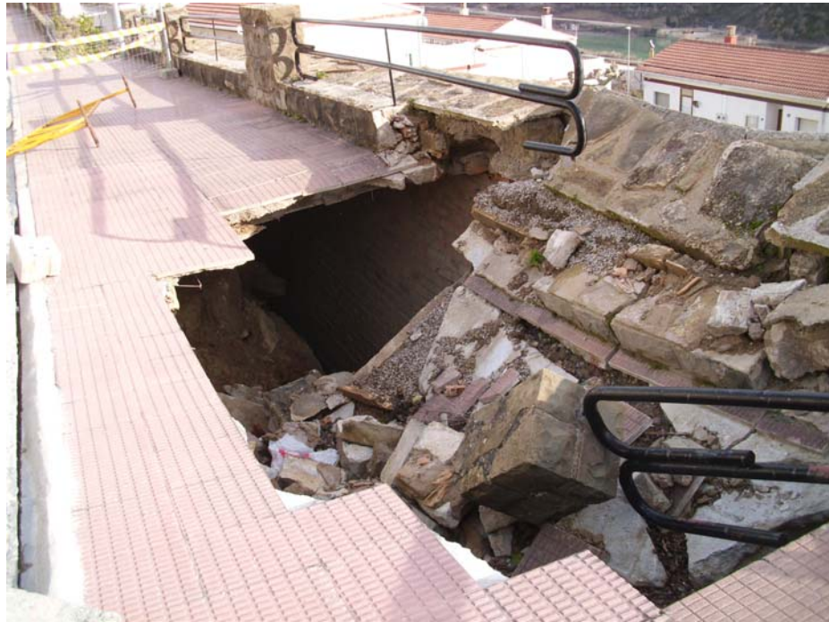
Figura 4.1.15: Hundimiento de una acera en la calle 3 de la urbanización Lasaitasuna, coincidiendo con el límite Oeste de la masa inestable. Se observa como la acera consiste en un forjado de viguetas de hormigón, apoyado en una pared de ladrillos y bajo el que no se dispuso en su día de un relleno (posiblemente porque la pared de apoyo no hubiera resistido el empuje del relleno).
