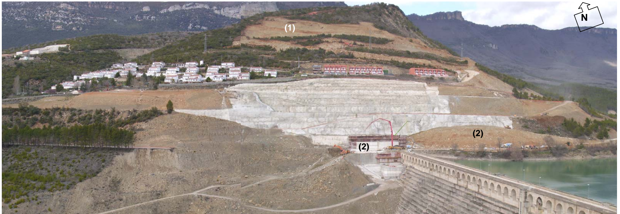
Figura 3.5.11: Vista de la ladera derecha de la cerrada del embalse de Yesa desde la margen izquierda. Se observa el progreso de la excavación de la parte alta de la ladera (1) y de la aplicación de un peso estabilizador al pie de la masa inestable (2).
