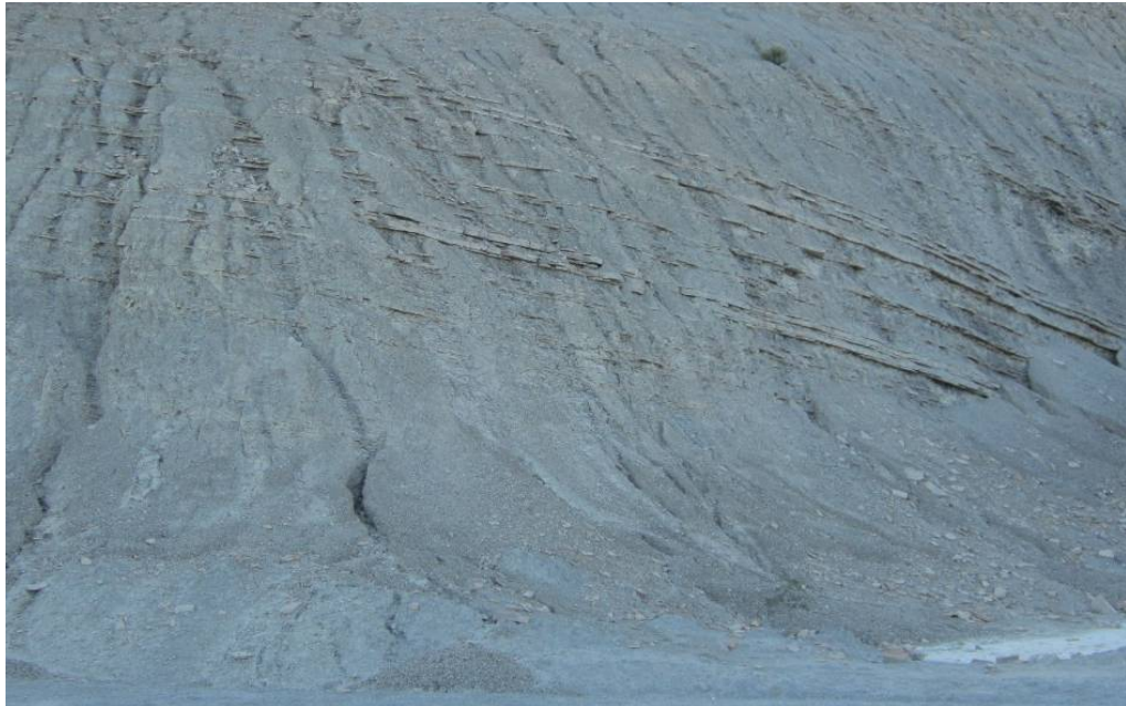
Figura 3.3.1: Vista de un talud excavado en margas de la parte alta de la serie, muy cerca del contacto con el flysch, con frecuentes intercalaciones de niveles de areniscas de espesor centimétrico.
