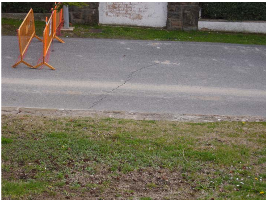
Figura 4.1.10: Límite Oeste de la masa inestable definido por una grieta en el vial inferior (calle 1) de la Urbanización Lasaitasuna.
