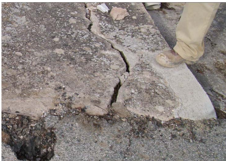
Figura 4.1.14: Detalle de la foto anterior en la acera junto a los garajes. Se observa como dicha grieta se encontraba previamente rejuntable con mortero.
