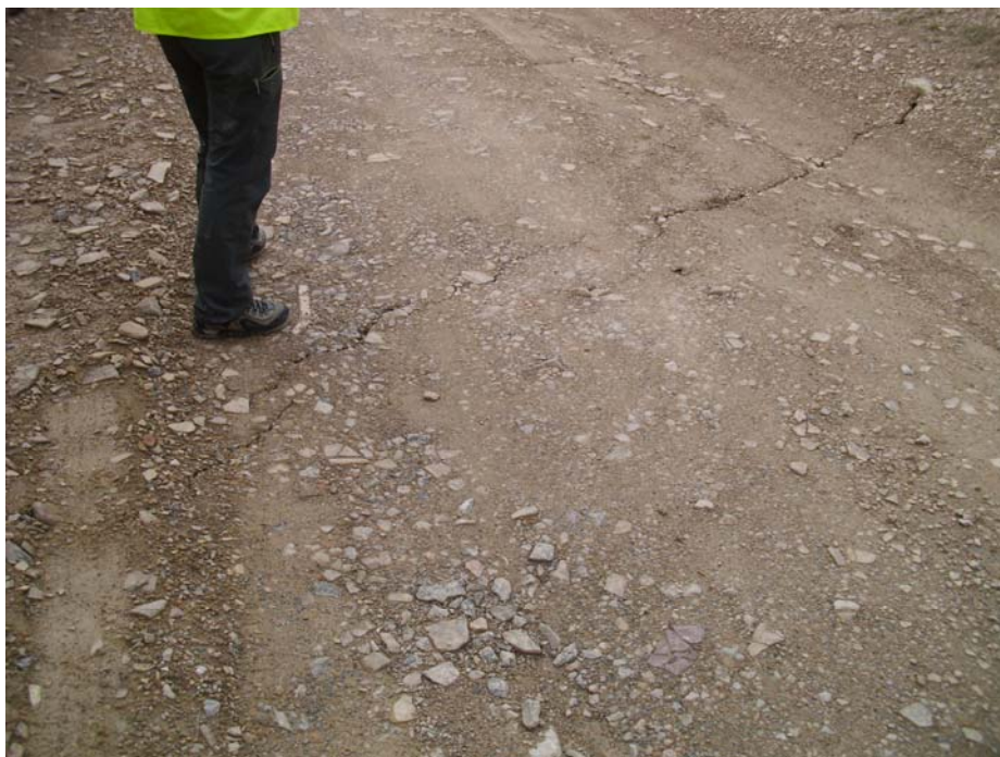
Figura 4.1.5: Límite Este de la masa desplazada que se observa en el camino bajo la carretera N-240. Se observa una grieta que sigue la proyección de la estratificación sobre la superficie horizontal del camino.
