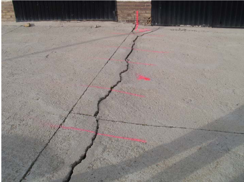
Figura 4.1.19: Vista de la grieta transversal observada en le calle 4 de la Urbanización Lasaitasuna, prolongación de la observada en la calle 3 y que afecta a la vivienda nº20. Se observa un salto lateral de unos 3 cm y un salto vertical de 1 cm. Se trata de una grieta que ya se encontraba rejuntada anteriormente y en la que se ha producido una reapertura mayor. Límite Oeste del deslizamiento.
