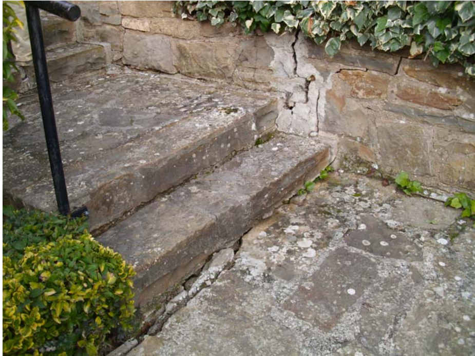
Figura 4.1.11: Límite Oeste de la masa inestable que provoca apertura de grietas pre existentes en muros y elementos de contención de la Urbanización Lasaitasuna.
