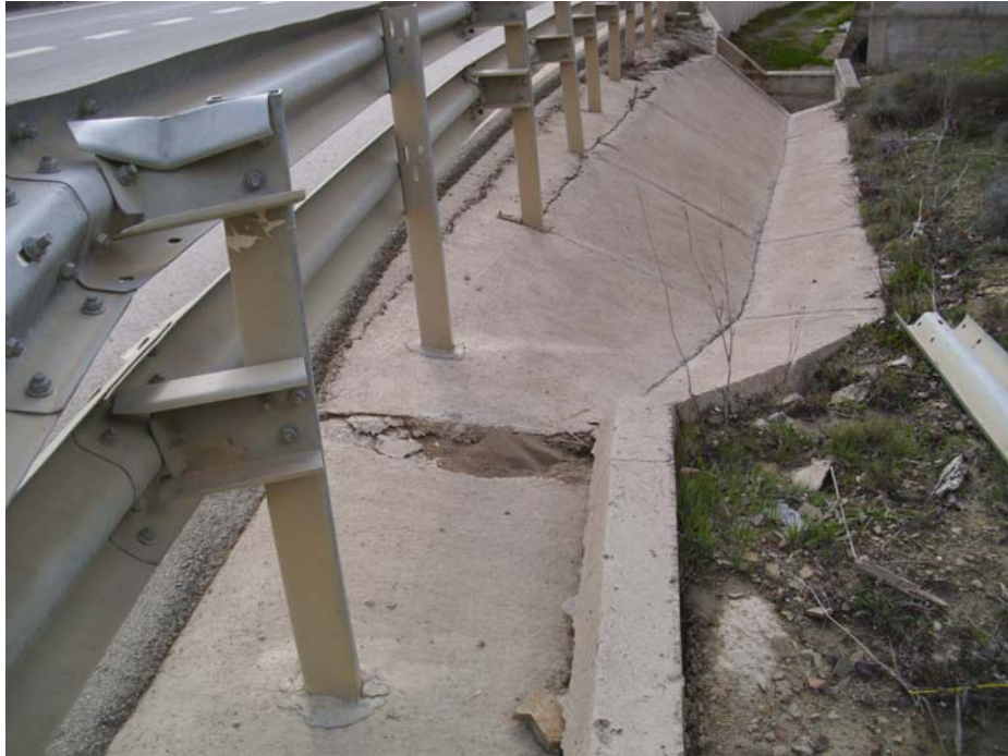
Figura 4.1.7: Límite Oeste de la masa inestable que provoca la rotura de la cuneta de la carretera N-240. En la calzada no se ve una grieta transversal, si bien se observa la apertura de la calzada a lo largo de una junta longitudinal del aglomerado (figura 4.1.8).
