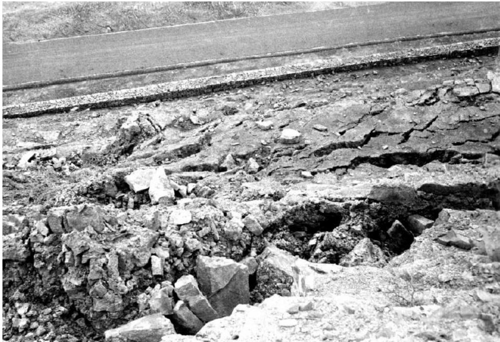
Figura 2.2: Detalle de la degradación que presentaba el abancalamiento del talud de la ladera derecha en 1964. Servicio Geológico de Obras Públicas.
