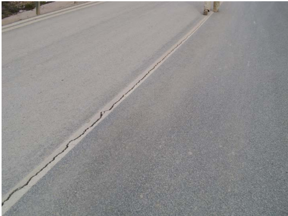
Figura 4.1.8: Límite Oeste de la masa inestable que provoca la apertura de la calzada a lo largo de una junta longitudinal del aglomerado. El hecho de no observarse con claridad el límite lateral de la masa movilizada muestra la escasa actividad del movimiento observado.
