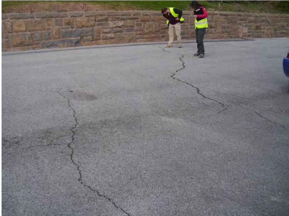
Figura 4.1.9: Límite Oeste de la masa inestable que provoca grietas en los viales de la Urbanización Lasaitasuna. Vista de la calle 2.
