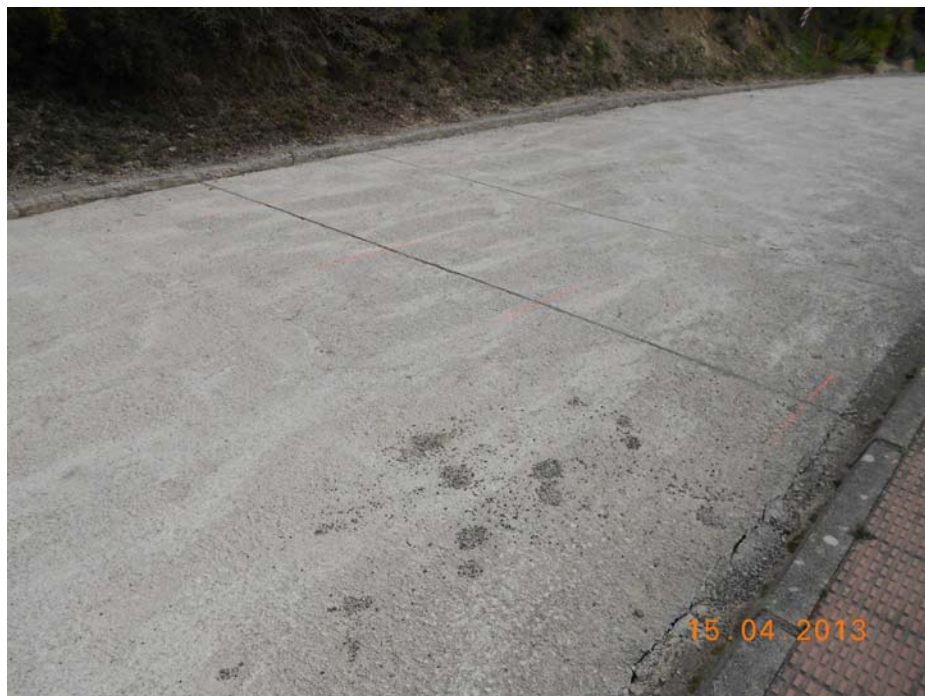
Figura 4.1.21: Apertura de una junta de hormigonado en la calle 4, a una distancia de 30 m al Este de la grieta de la figura 4.1.19 (la que define el límite Oeste del deslizamiento) y a 20 m al Oeste de la grieta intermedia mostrada en la figura 4.1.20.
