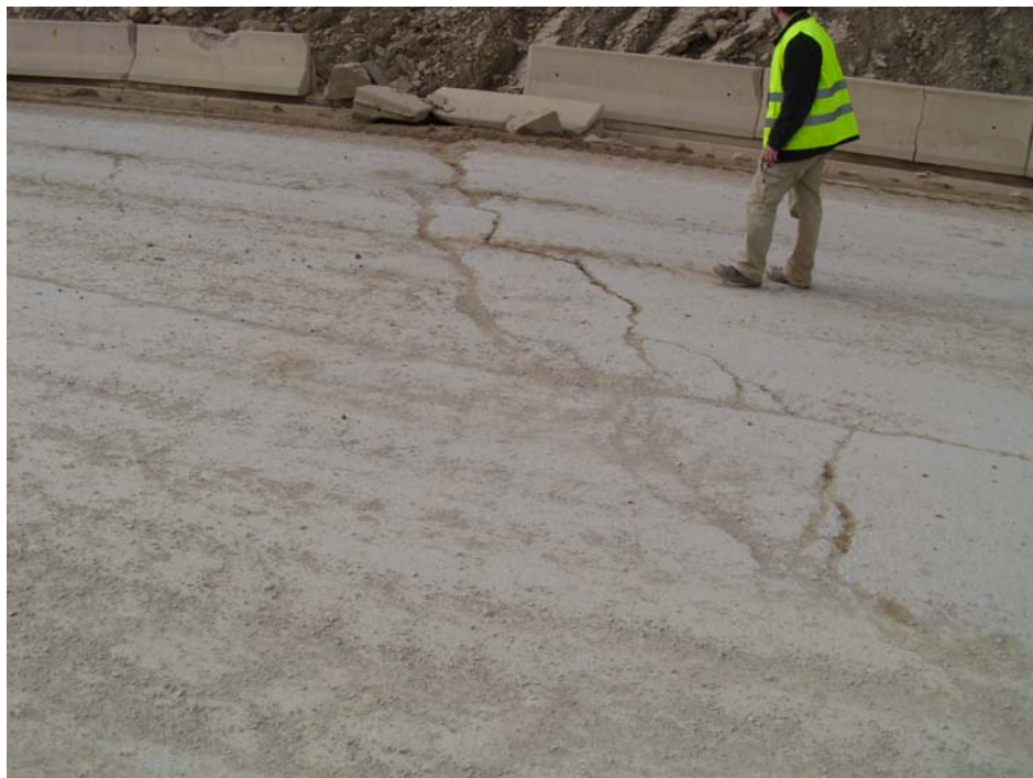
Figura 4.1.4: Límite Este de la masa inestable marcada con claridad en la carretera N-240. Se observa una grieta que sigue la proyección de la estratificación sobre la superficie horizontal de la calzada.
