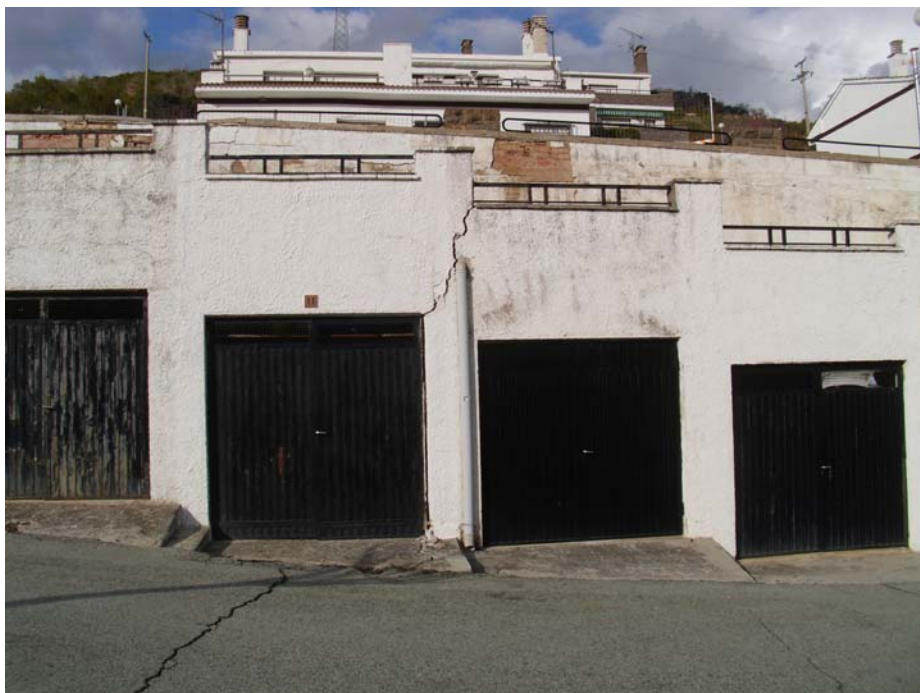
Figura 4.1.13: Límite Oeste de la masa inestable que provoca apertura de una grieta en el vial intermedio de la Urbanización Lasaitasuna y en unos garajes.
