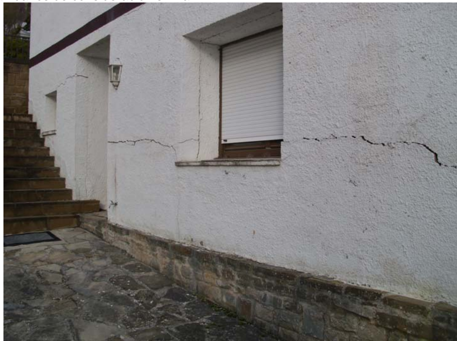
Figura 4.1.18: Vista de la fachada al patio de la vivienda nº 20, situada en la calle 3 de la urbanización Lasaitasuna, coincidiendo con el límite Oeste de la masa inestable. Se observan grietas provocadas por el movimiento diferencial del terreno. La mala calidad de la construcción, ha provocado que la cimentación no se haya comportado como un elemento rígido, permitiendo la distorsión de la estructura.
